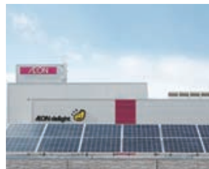
当社研修施設「イオンディライトアカデミーながはま」に据え付けられた太陽電池
