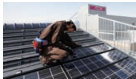
実際の住宅の高さに合わせて作られた、ソーラーパネル取り付け研修設備
