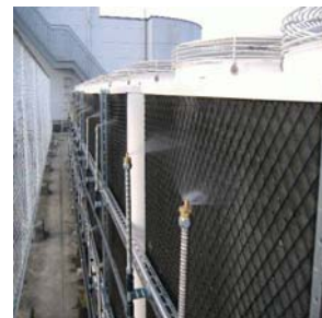
室外機散水装置
